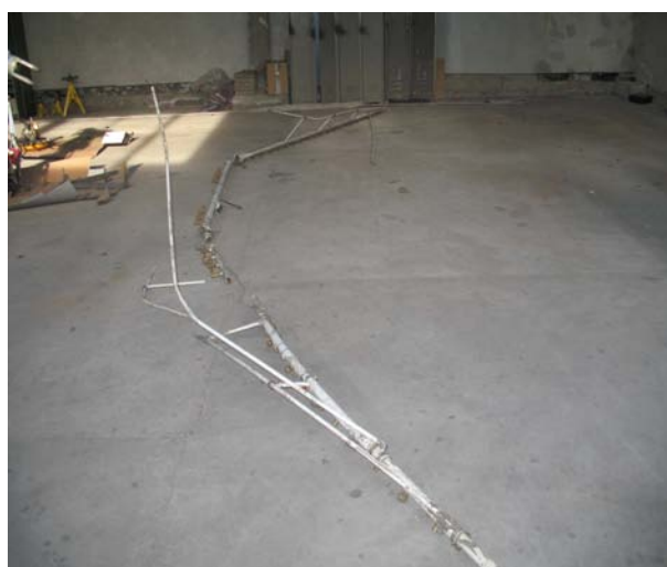
Сл. 7. - Изглед оштећене инсталације за запрашивање
